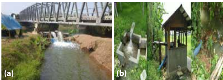
Gambar 22. Pemanfaatan air sungai melalui pompanisasi: (a) Pompanisasi Saluran Sekunder Pusakanegara, untuk irigasi di Kab. Indramayu (b) Pompanisasi Sungai Ciliuk, Desa Jaro, Kab. Tabalong, Kalsel
