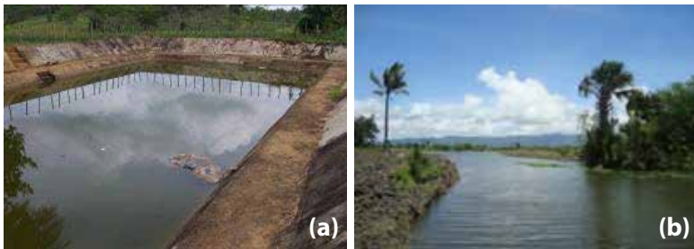
Gambar 23. Embung konstruksi pasangan batu di Gunung Sugih, Lampung Tengah (a) dan embung lapisan tanah di Naibonat, Kupang (b)
