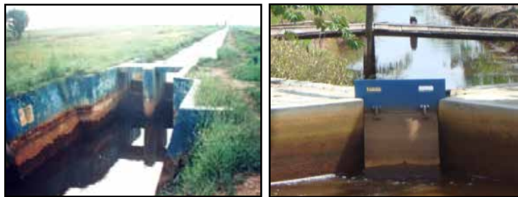
Gambar 18. Pintu air tabat (kiri) dan pintu airflapgate untuk aliran satu arah (kanan)
